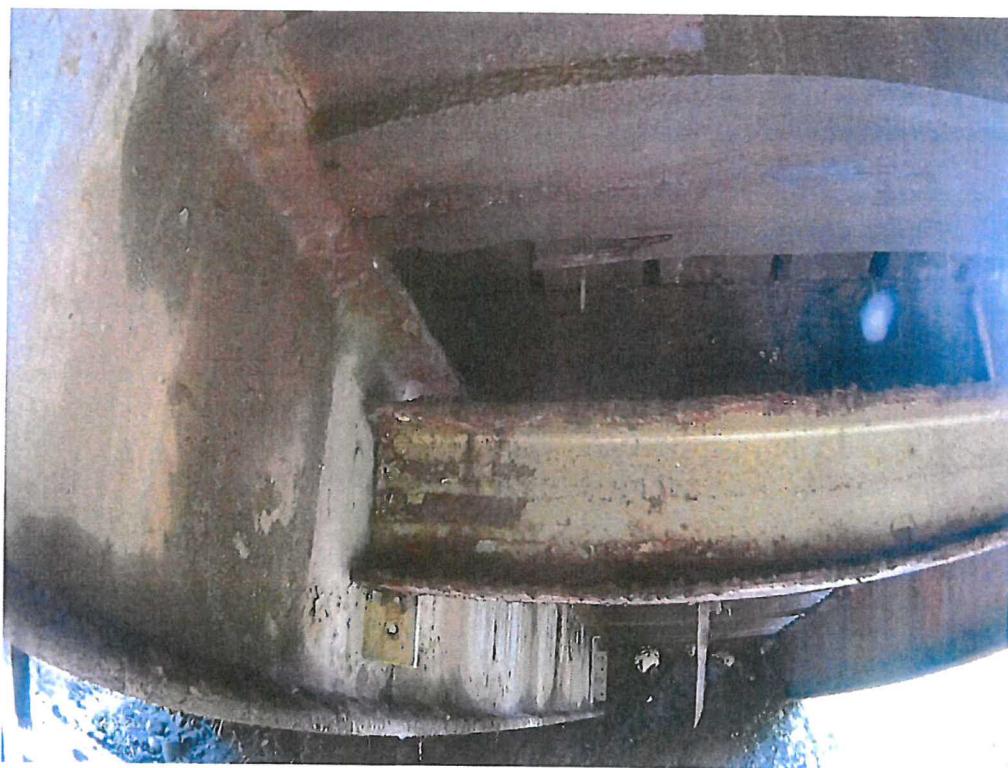
Fot. 4. Zaawansowana korozja jednego z dźwigarów
