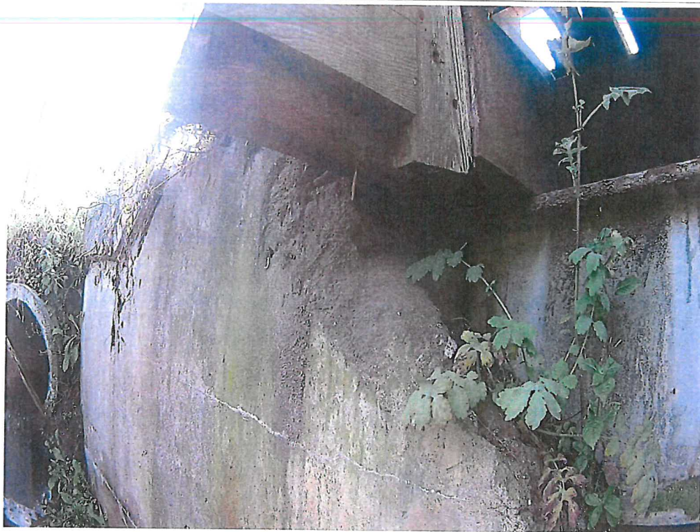
Fot. 3. Wykruszenie i zwilgocenie jednej z ścian przyczółka
