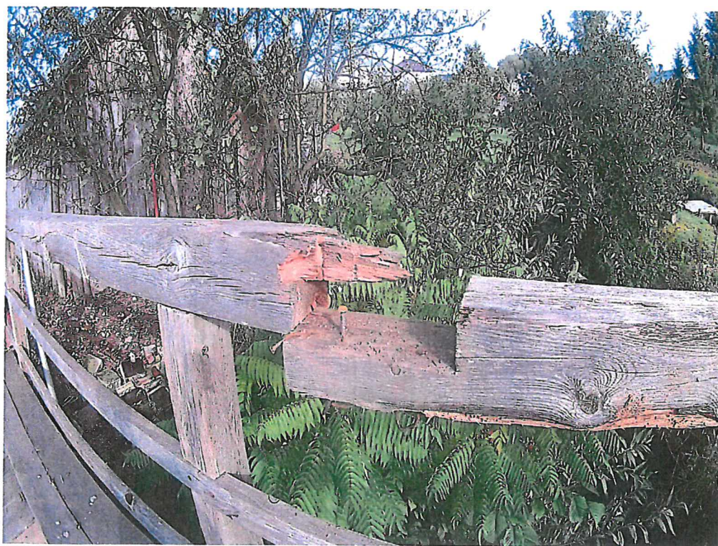
Fot. 2. Znaczny ubytek w konstrukcji bariery dla pieszych
