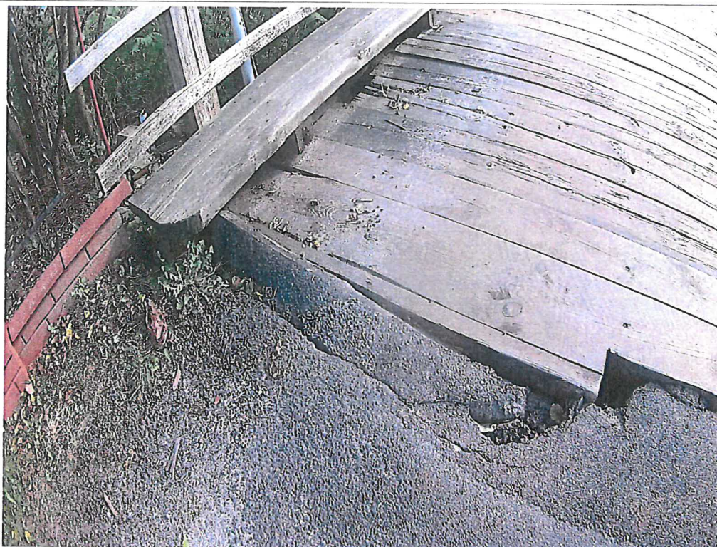
Fot. 1. Spękanie i ubytek nawierzchni jezdni
